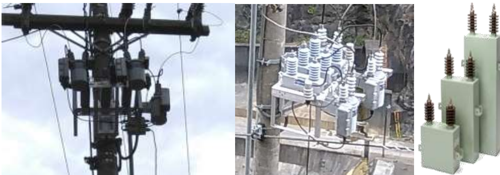
Ilustración 7 Vista de capacitores de diversos tamaños y un banco de capacitores colocado en la red eléctrica
