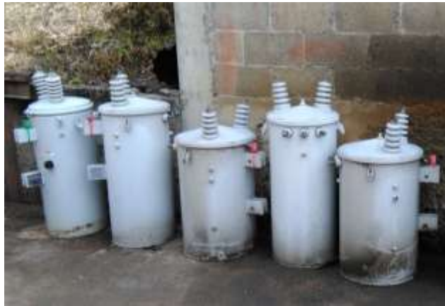
Ilustración 4 Vista de un transformador de distribución .
