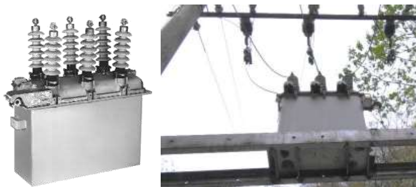
Ilustración 8 Vista de un reconector, desconectado y uno conectado a la red eléctrica
