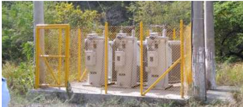
Ilustración 10 Vista de reguladores de voltaje para una red de distribución eléctrica
