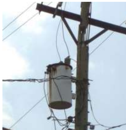
Ilustración 5 Vista de transformador en la red eléctrica
