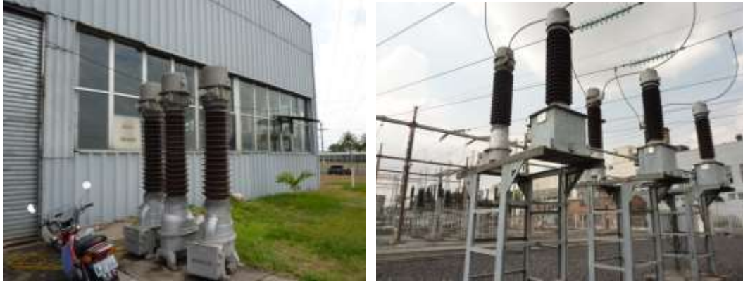
Ilustración 9 Vista de transformadores de corriente fuera de servicio y en operación
