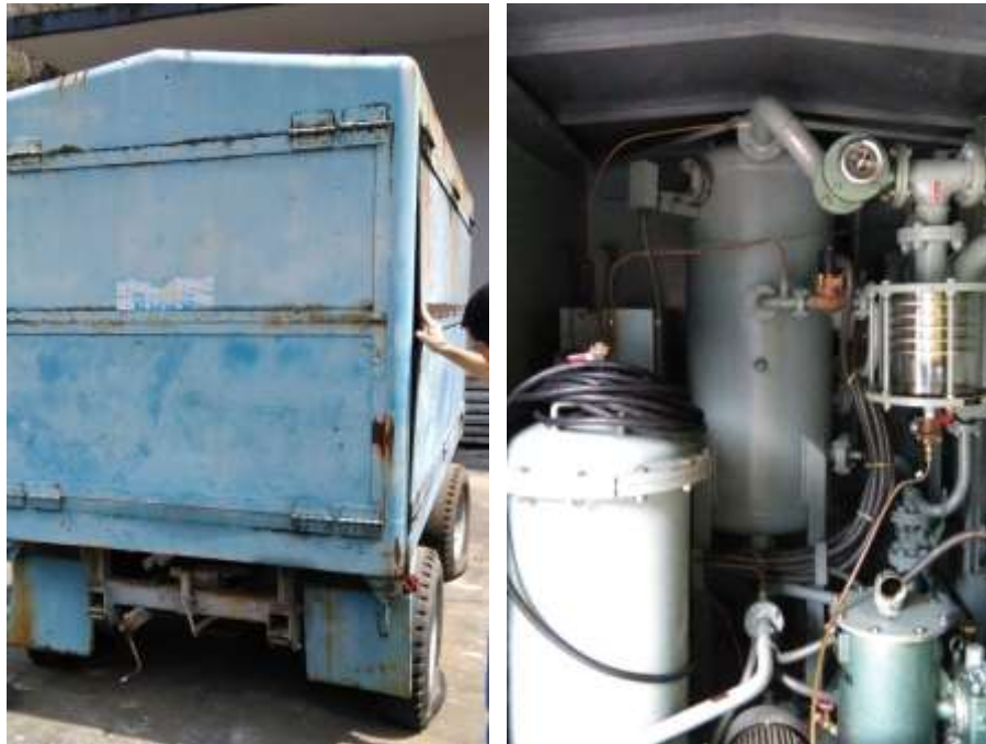
Ilustración 11 Vista de una máquina filtrante de aceite dieléctrico por el exterior e interior.
