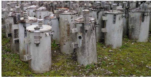
Ilustración 11 Vista de cubas de transformadores.
