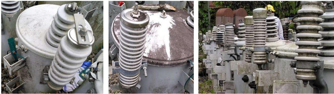
Ilustración 3 Detalle de pararrayos
