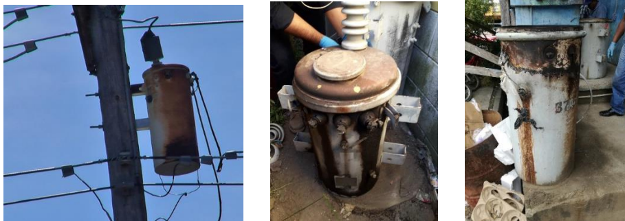
Ilustración 14 Aceite quemado por un transformador utilizado en condiciones de sobre carga
