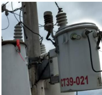
Ilustración 16 Vista de un pararrayos en un transformador
