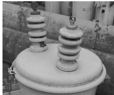
Ilustración 2 Bushing primario en transformador de distribución
